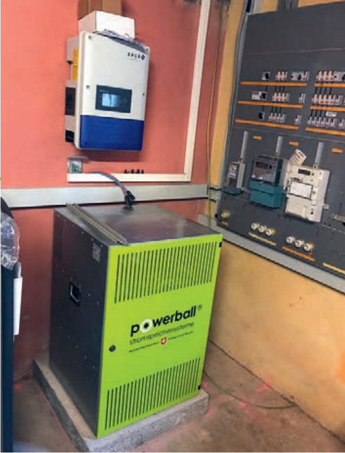
Eine AC-Ankoppelung zeichnet sich durch die hohe Flexibilität aus: Das Speichersystem kann unabhängig von der Photovoltaikanlage installiert werden. Bildquelle: Tritec
